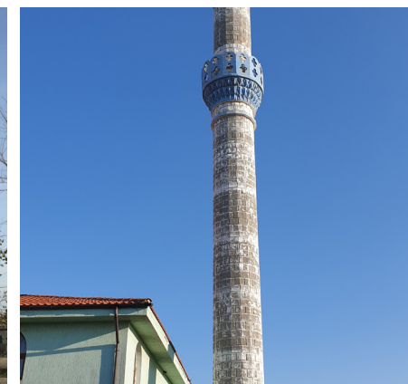
Fig. 98 - Materialele de finisaj trebuie să fie de bună calitate și puse corect în operă, cu înțelegerea problemelor de fizica construcțiilor, pentru a se evita deteriorarea finisajelor
