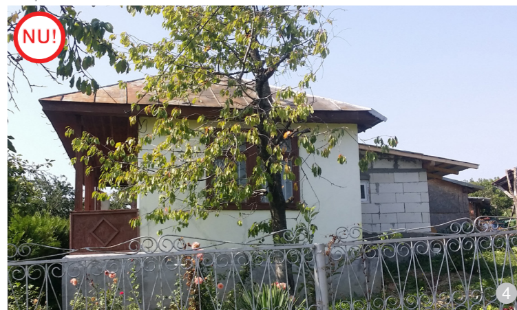
AȘA NU: Pentru refacerea sau adăugarea chilerului construcției din imagine, s-a optat pentru blocuri de BCA, material care nu este compatibil cu cele din care sunt construiți pereții casei. Casele existente (tradiționale) se vor repara cu aceleași materiale din care au fost construite, folosind aceleași tehnici de construcție. Același principiu se va respecta și la extinderile care sunt legate de corpul casei extinse.
