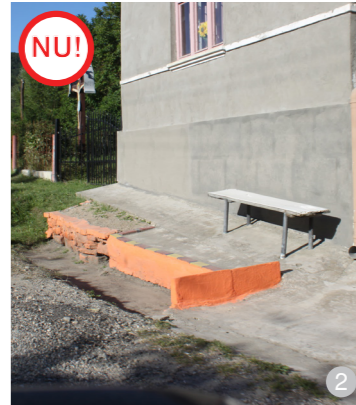
AȘA NU: Este interzisă betonarea trotuarelor de lângă casă, deoarece această soluție provoacă igrasie pereților prin transferul apei din betonul trotuarului în pereții casei. De asemenea, nu permite pereților să respire, înmagazinând un surplus de umezeală care conduce la igrasie și mucegal/ciuperca la interior.
