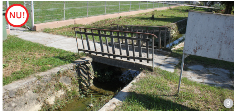
AȘA NU: Nu se recomandă folosirea betonului și balustradele de metal pentru podețe, deoarece se degradează foarte repede și nu sunt specifice mediului rural.
