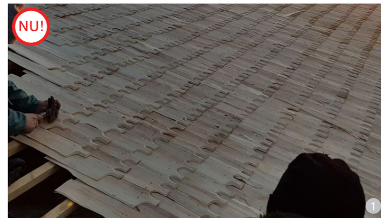
AȘA NU: Nu se recomandă montajul cuiului la vedere. Acest lucru contribuie la degradarea materialului lemnos prin infiltrarea apei de ploaie în zona penetrată de cui.
