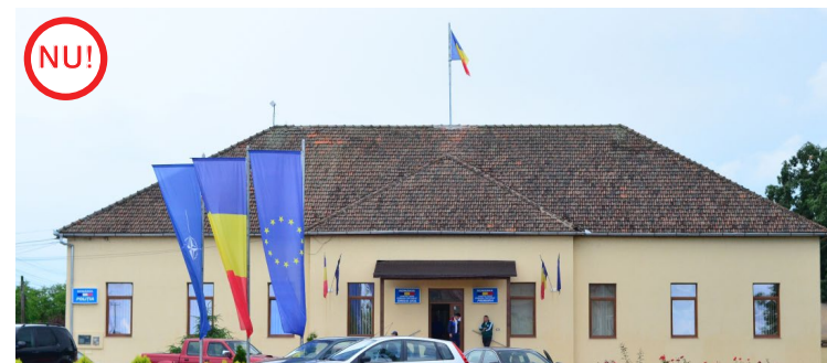
AȘA NU: Reabilitare termică neadecvată a unei clădiri istorice cu eliminarea mulurilor specifice.
