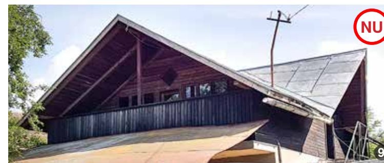
AȘA NU: [5-8] Configurarea acoperișurilor cu forme atipice, cu ruperi de pantă, cu pantele decalate, cu frontoane sau lucarne de mari dimensiuni, contrastează cu imaginea construcțiilor tradiționale. În cele mai multe zone, acoperișul este în patru ape, cu pante egale și rezolvări clasice pentru intersecții de volume. Orice altă configurație a acoperișului, în afara celor caracteristice zonei în care este amplasată investiția, va fi greu de integrat în țesutul satului tradițional.
